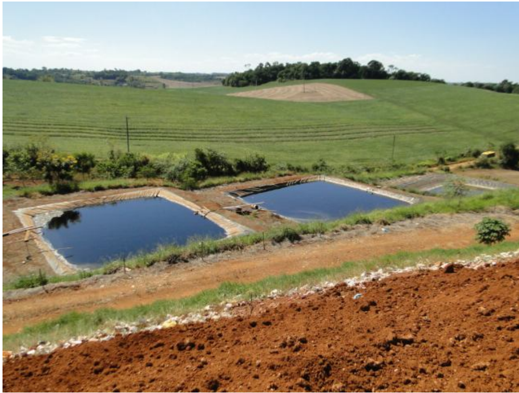
Figura 13 – Estação de tratamento de efluentes
